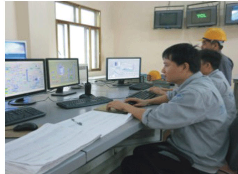
Thiết bị được điều khiển tự động từ trung tâm điều khiển
