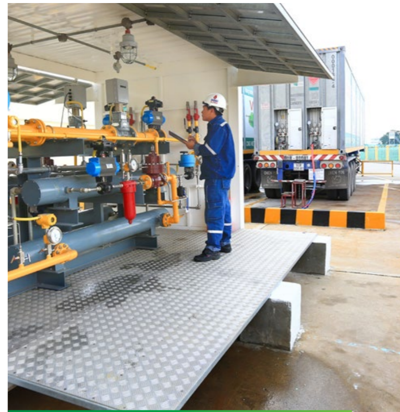
Trạm giảm áp PRU tại Công ty Toto - KCN Bắc Thăng Long, Hà Nội.
