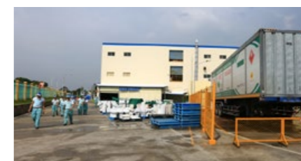
Trạm giảm áp PRU tại Công ty Toto - KCN Bắc Thăng Long, Hà Nội.
