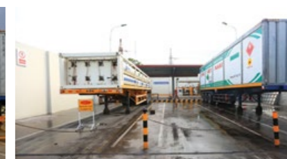
Trạm giảm áp PRU tại Công ty Kyoei Việt Nam - Tam Điệp, Ninh Bình.
