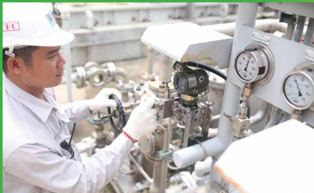
Công tác bảo dưỡng định kỳ tại nhà máy Đạm Cà Mau
