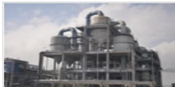
Nhà máy sản xuất Axít Photphoric (PA)
