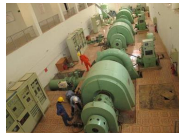
Nhà máy thủy điện Đa Khai
