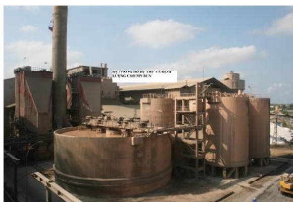
Hệ thống bồn chứa và máy nghiền bùn
