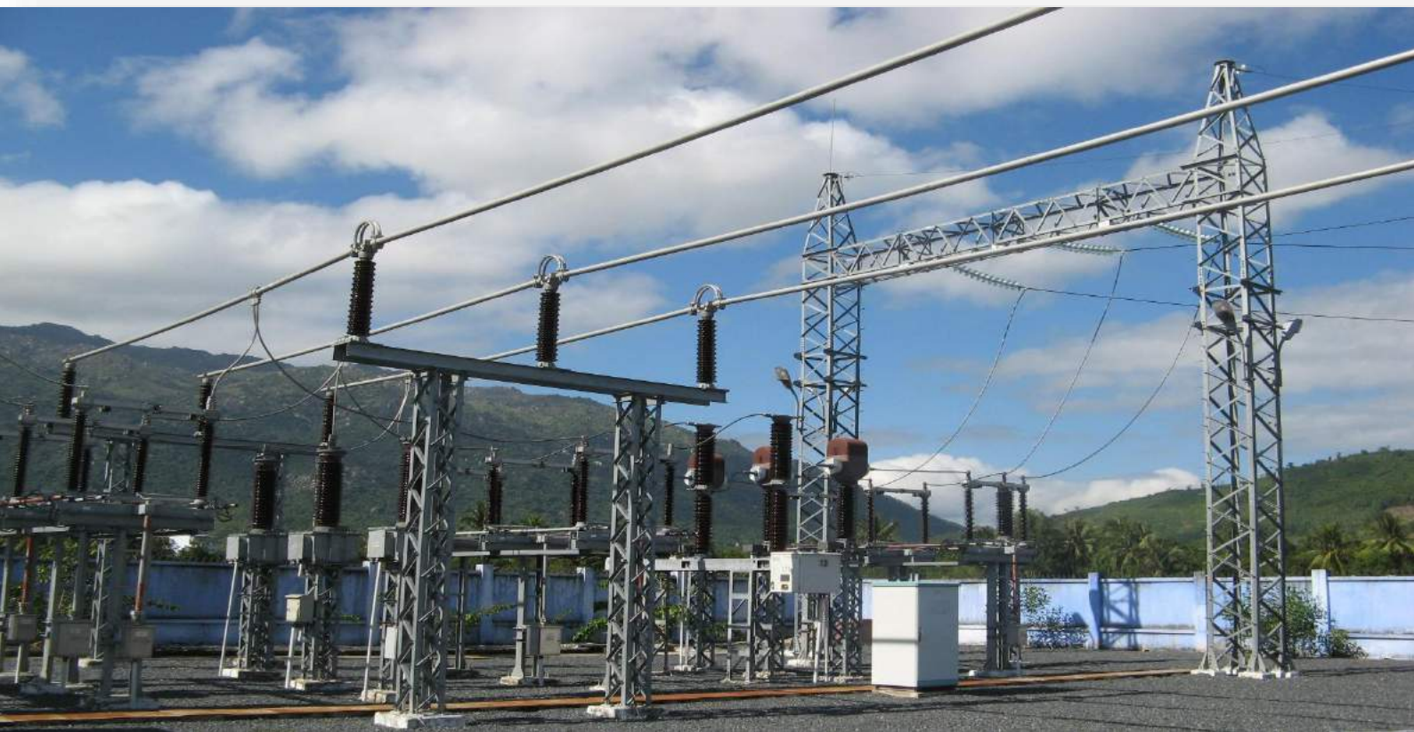
Trạm biến áp 110kV Diên Khánh
