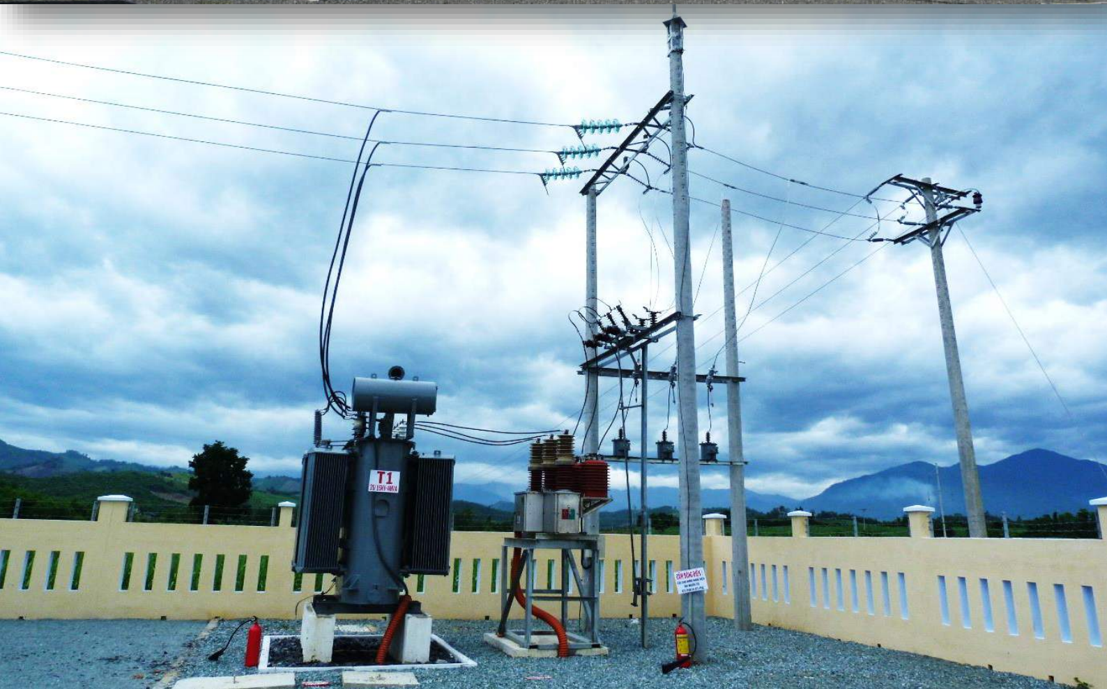
Trạm 35kV F6C Khánh Vinh
