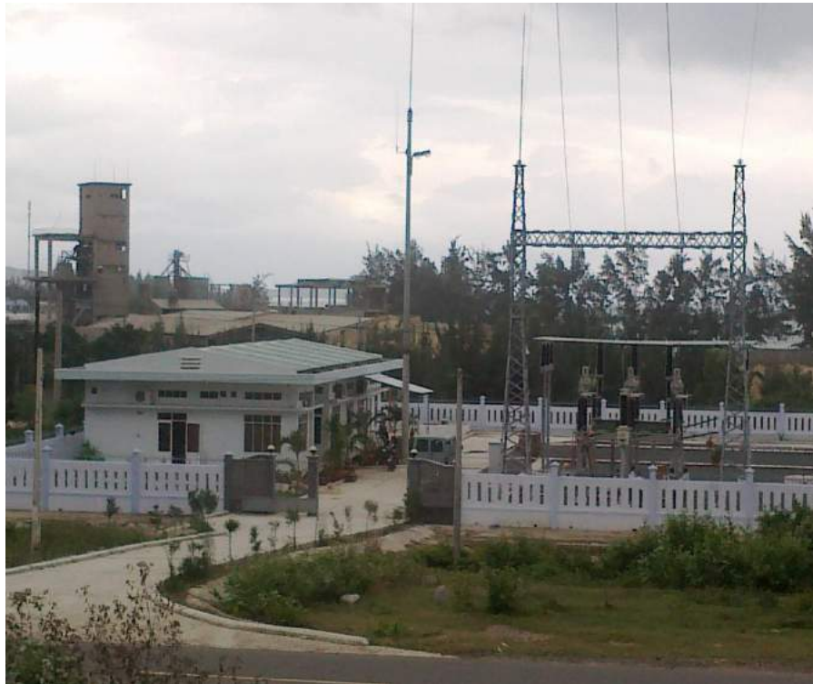
Trạm biến áp 110kV Ninh Thủy
