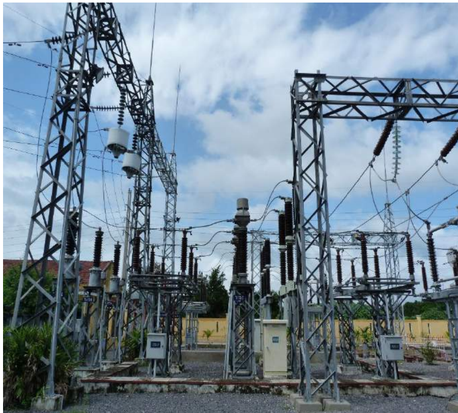
Trạm biến áp 110kV E24
