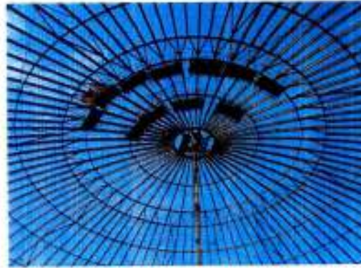
Thi công kết cấu mái vòm bể xăng dầu tại Vân Phong
