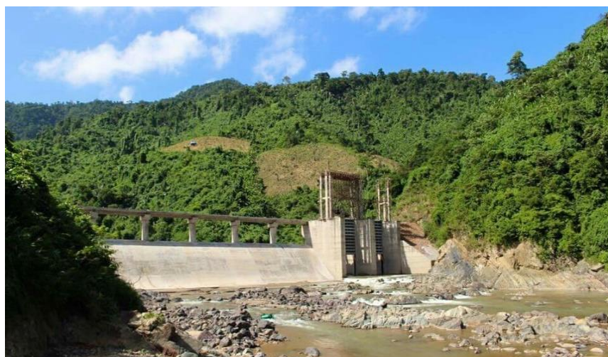
Toàn cảnh Đập dâng – Đập tràn công trình thủy điện Đa Krông 1 đang được hoàn thiện
