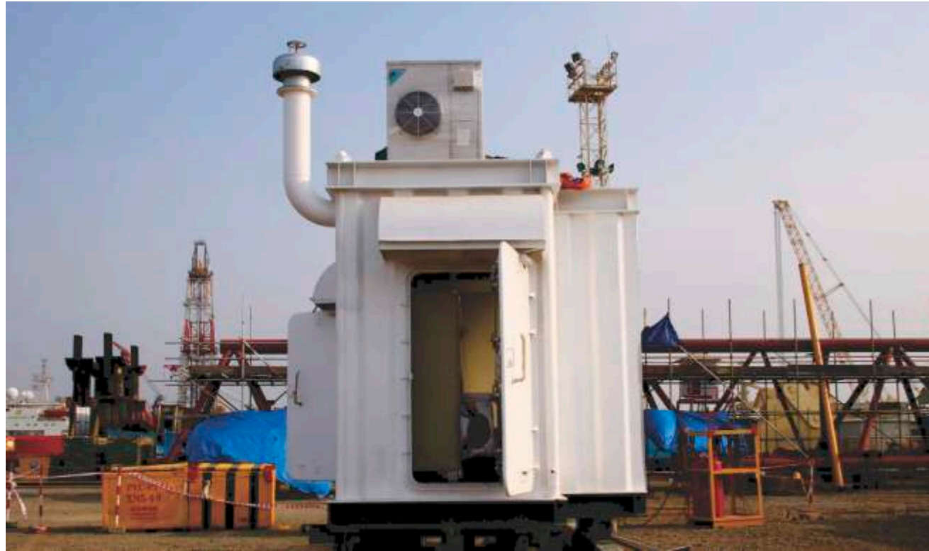
(Lắp đặt và hoàn thiện Phòng UPS & Battery cho XN Xây lắp, Khảo sát và Sửa chữa - VSP)
