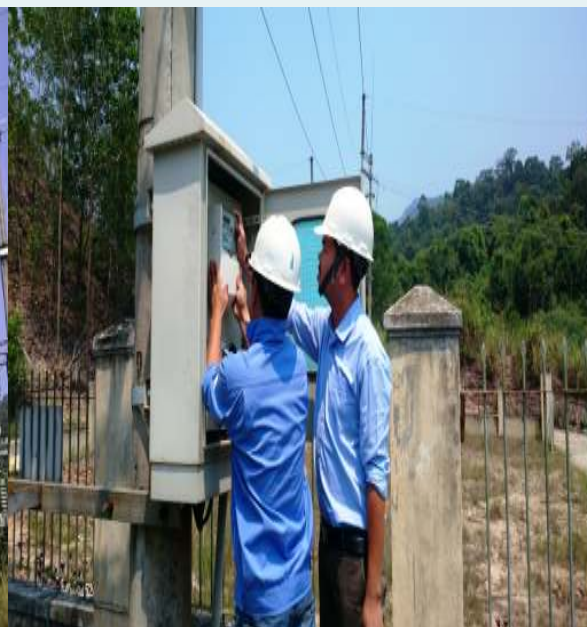
Kiểm định hệ thống đo đếm điện năng
